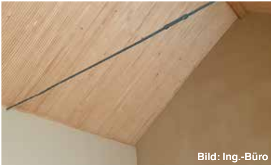
Abb. 13 Hier ist eine Dachuntersicht aus klassischen Brettstapелеlementen zu sehen. Die Fugen sind betont ausgeführt und systemtypisch.
